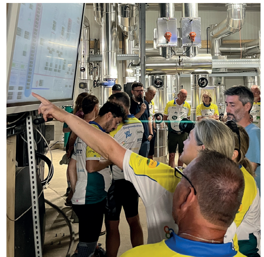
Wärmeverteilstation der Biogasanlage Alfhausen, die das Wärmenetz versorgt. Quelle: Christine-Buse/LEE NRW
