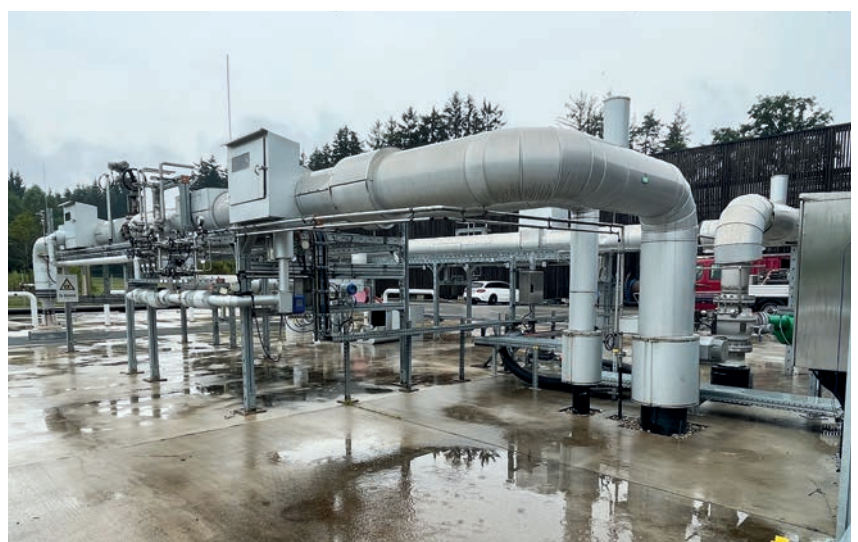
Die Geothermiebohrungen des Erdwärme-Grünwald-Geothermieheizkraftwerks in Laufzorn: Hier kommt das heiße Wasser aus dem Boden, das zur Wärme- und Stromversorgung genutzt wird (Produktionsbohrung). Und hier wird das abgekühlte Wasser, nachdem es seine Wärme abgegeben hat, wieder in den Boden geleitet (Reinjektionsbohrung)
